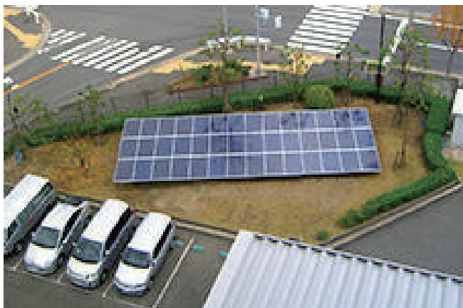
関西工場（寝屋川）の太陽光パネル
