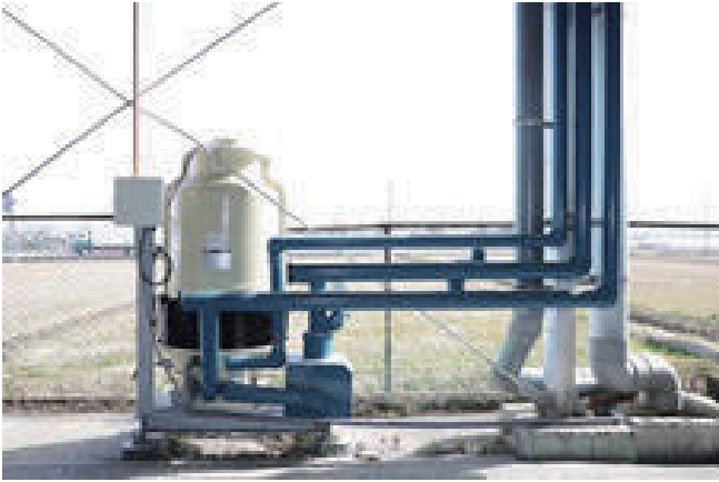
クーリングタワー（設備機器（スチール棚））
