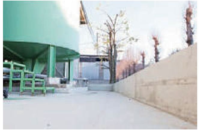
排水処理設備の防液堤
