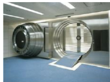
金庫扉・ボルトウォール
