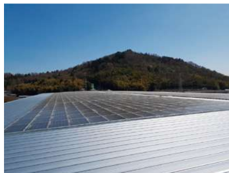
APセンターのオンサイトPPA方式による太陽光発電システム (2023年2月稼働)
