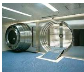
金庫扉・ボルトウォール
