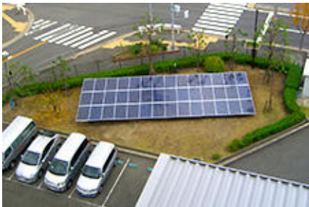
寝屋川工場の太陽光パネル
