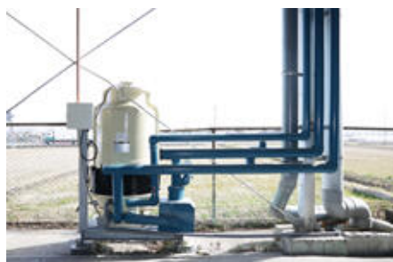
クーリングタワー（京都工場 2016年導入）
