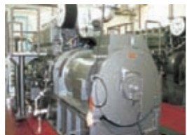
コージェネレーション設備
