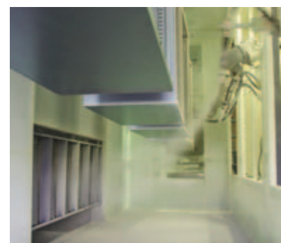
キャビネットの生産で導入された粉体塗装ライン
