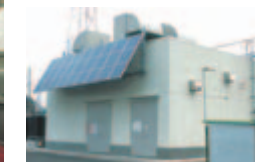
コージェネレーション設備
