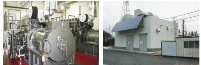
コージェネレーション設備
