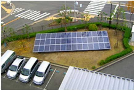
寝屋川工場の太陽光パネル
