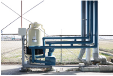
クーリングタワー（京都工場 2016年導入）
