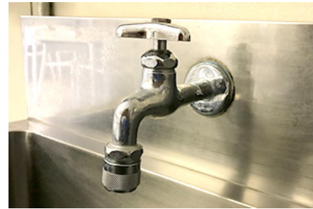
滋賀工場で導入した節水ノズル
