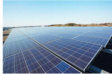
関東工場（千葉）の太陽電池出力太陽光パネル
