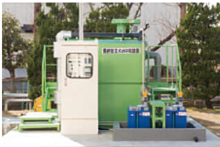
排水処理設備
