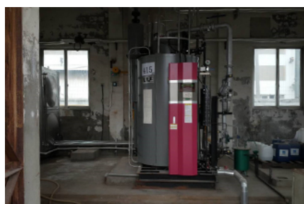
高効率ボイラーの導入
