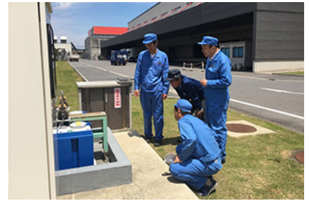
内部監査 現場確認
