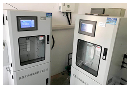
汚水オンライン監視設備
