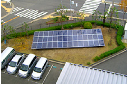
寝屋川工場の太陽光パネル
