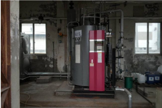
高効率ボイラーの導入
