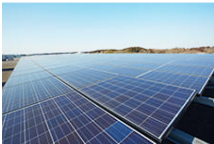
関東工場（千葉）の太陽電池出力が100kwの太陽光パネル
