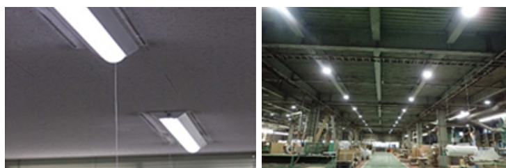
LED照明への切替え
