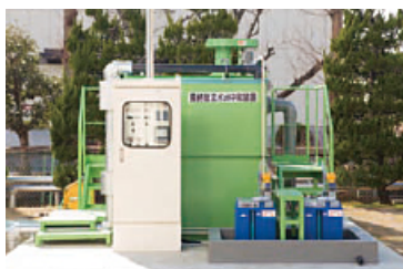
排水処理設備
