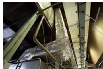
環境負荷低減の起点となった ヤニ漏れ解消ダクト
