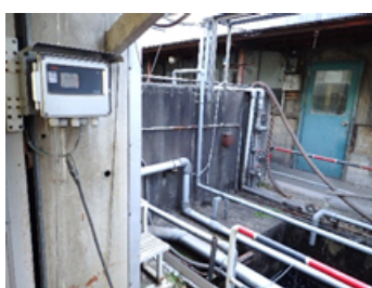
排水設備に管理計設置 異常時アラーム警告
