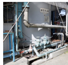
新設された排水処理施設により水の 使用量を20%削減
