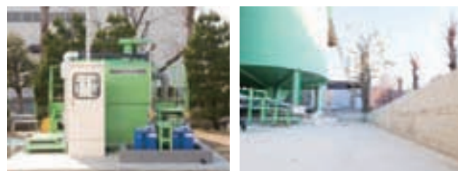
排水処理設備
