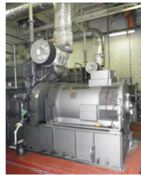
滋賀工場の自家発電装置
