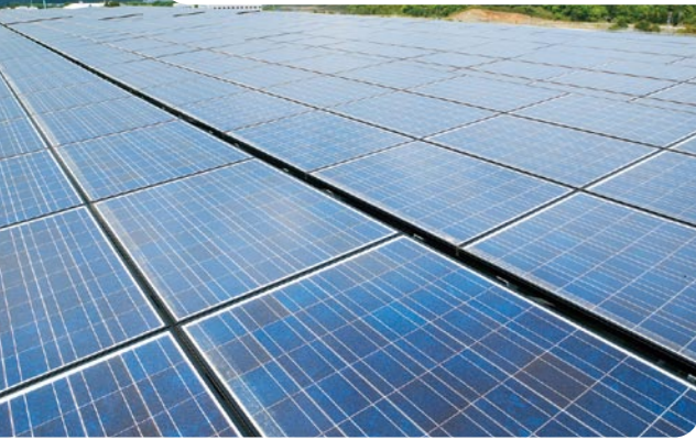
千葉工場に導入された太陽光パネル
