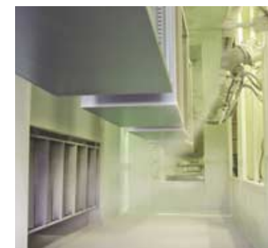
キャビネットの生産で導入された粉体塗装ライン
