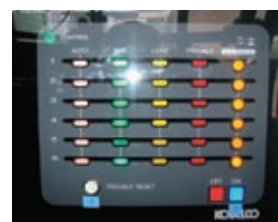
▲台数制御盤運転表示パネル
