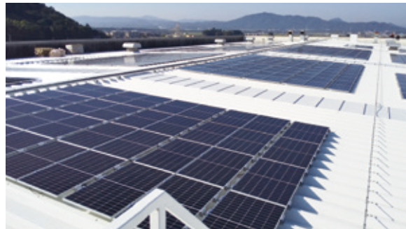
関西工場（滋賀）太陽光パネル
