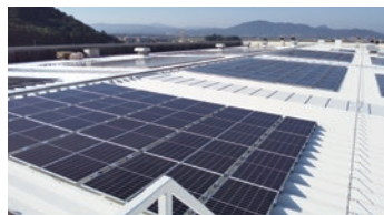
関西工場（滋賀）太陽光パネル
